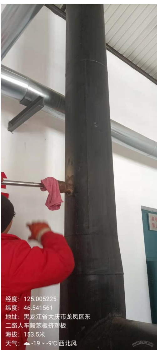
一区注水变电队
