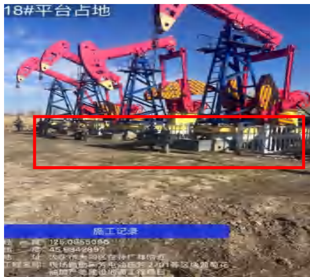
18#平台抽油机减震基础
