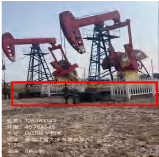
6#平台抽油机减震基础
