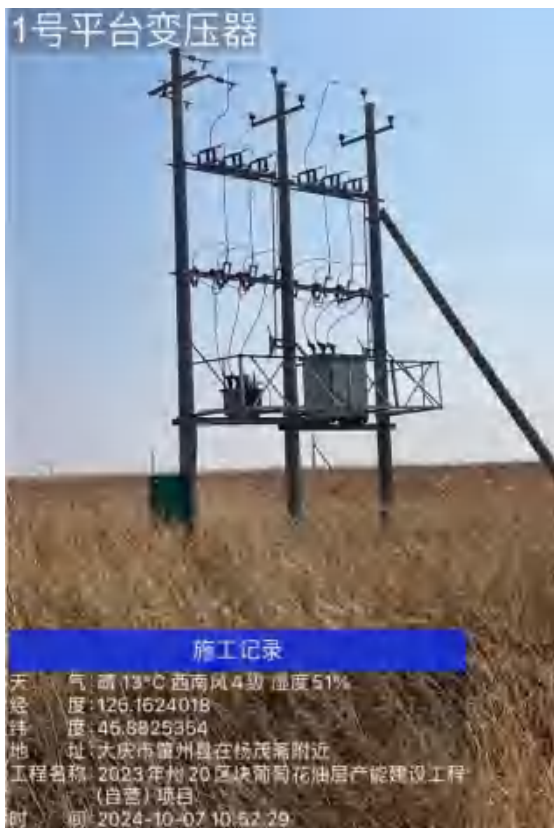
1#平台井变压器现状
