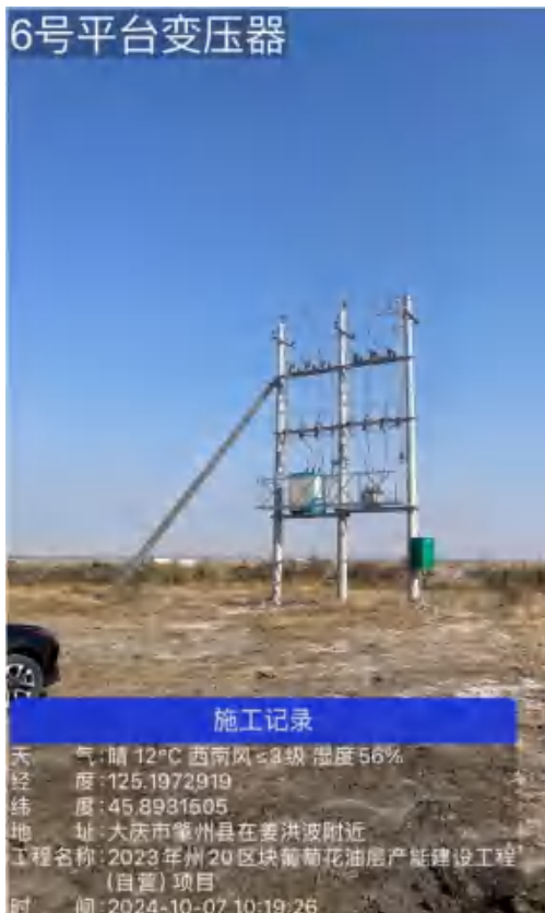
6#平台井变压器现状
