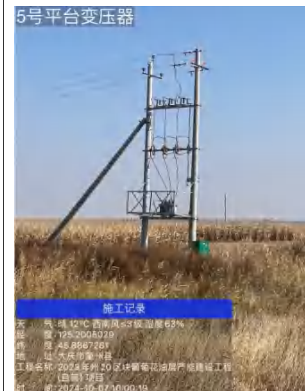
5#平台井变压器现状
