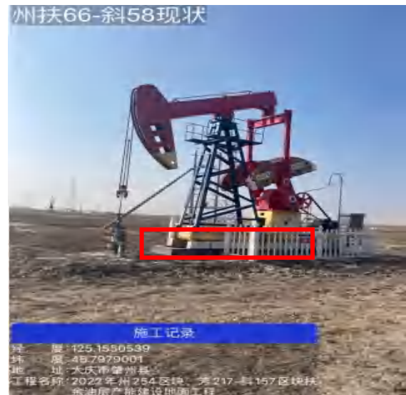
州扶 66-斜 58 抽油机减震基础
