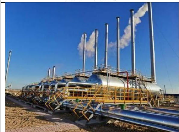
聚杏四-I 转油放水站
