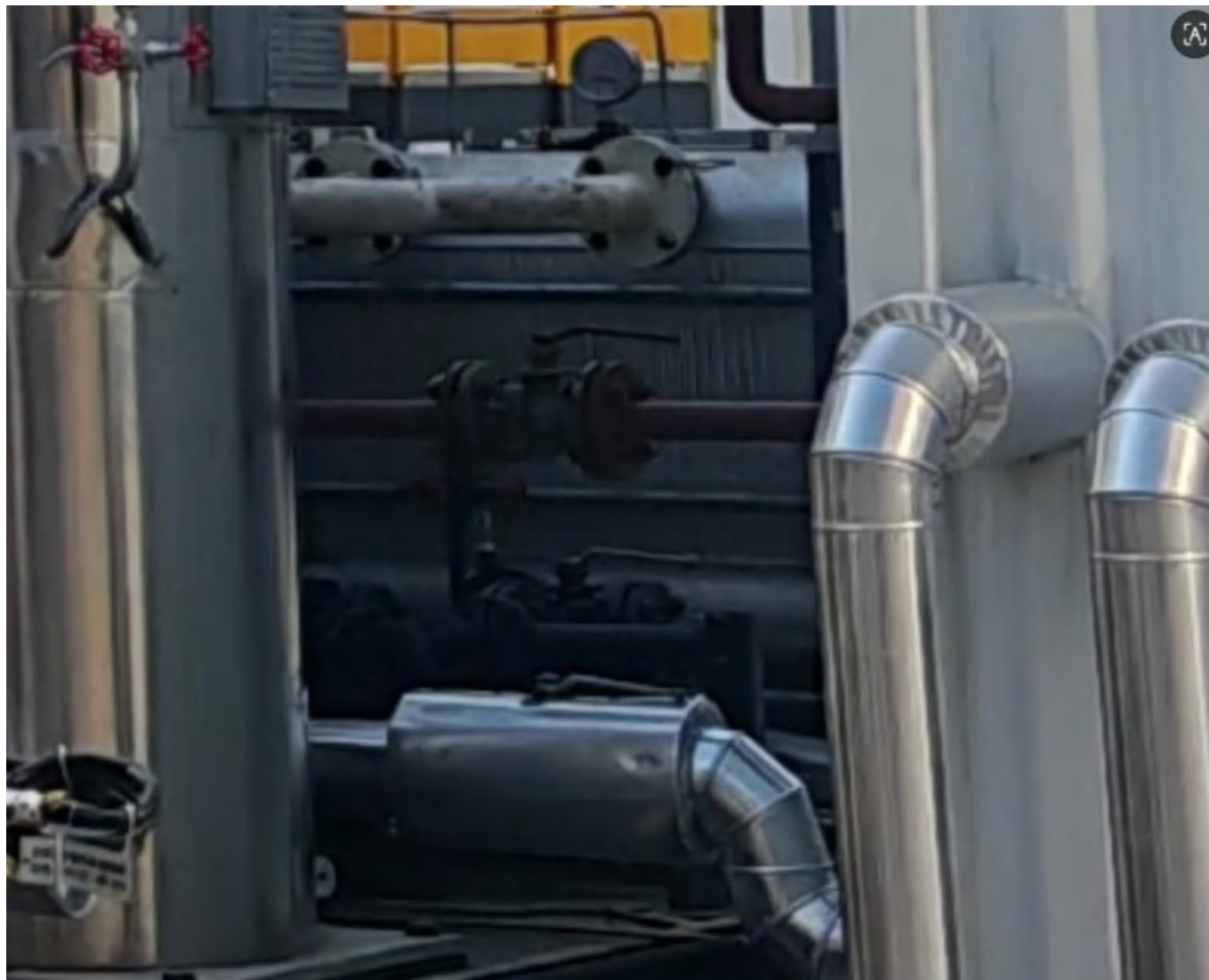
循环泵、换热器
