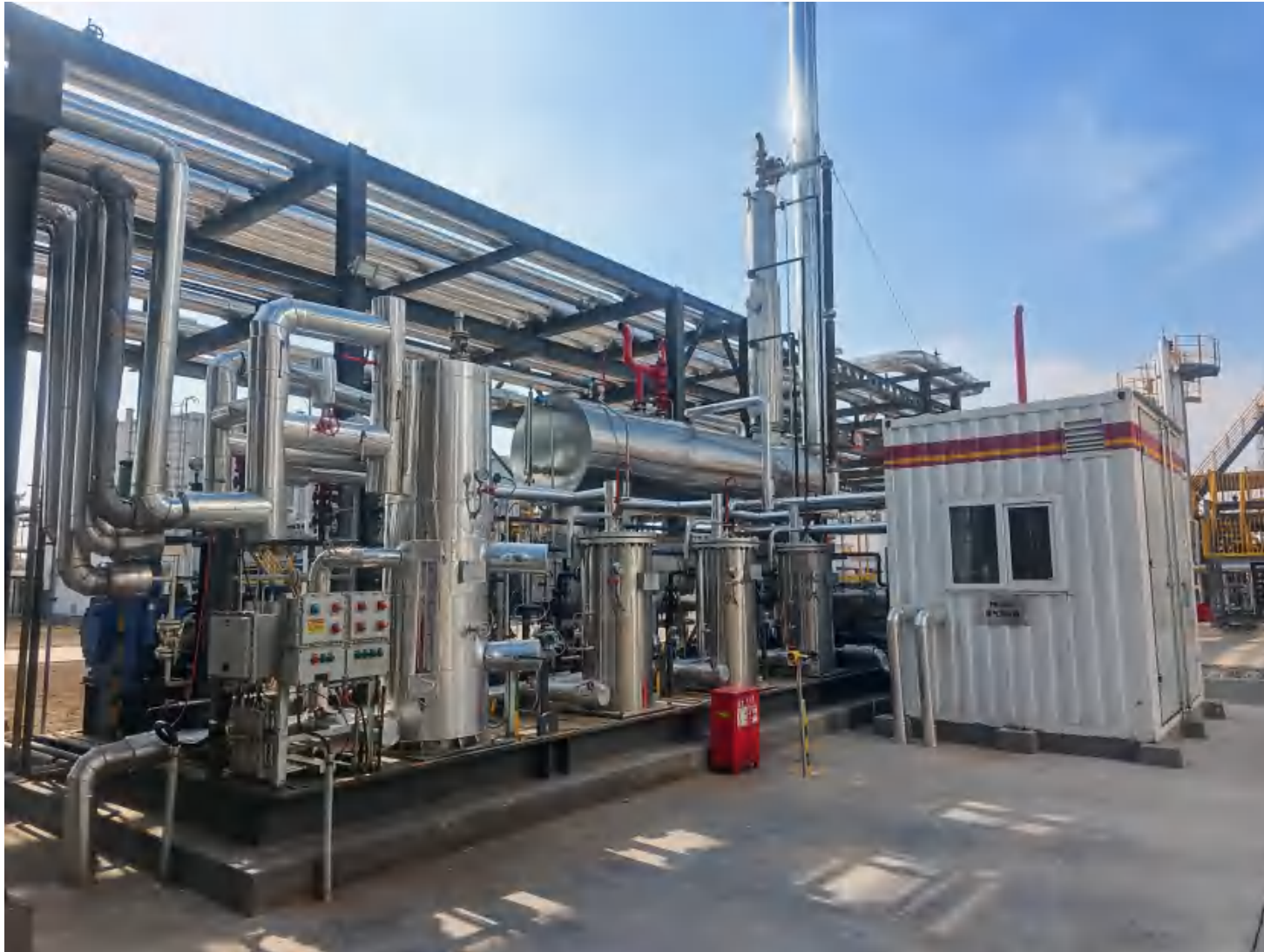
闪蒸罐、过滤器
