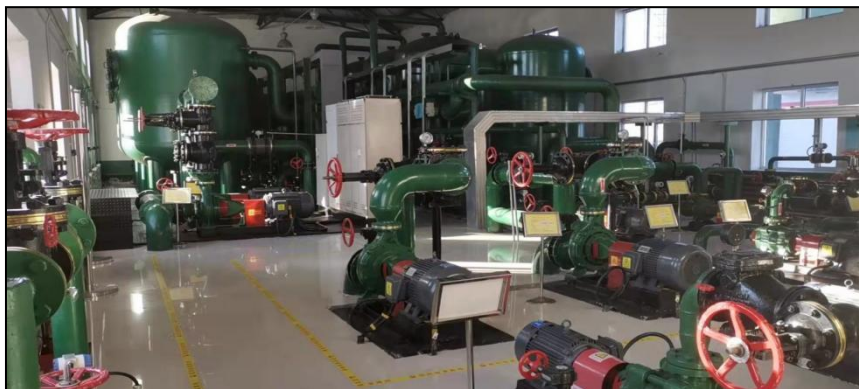
图 3- 4 源二联地下水深度处理站现状图
