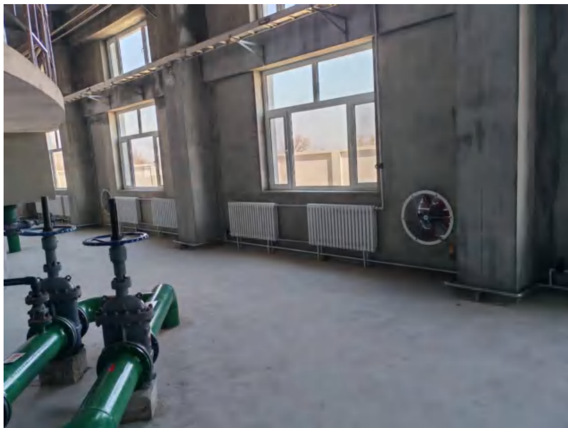
附件 8 现场环保设备照片
