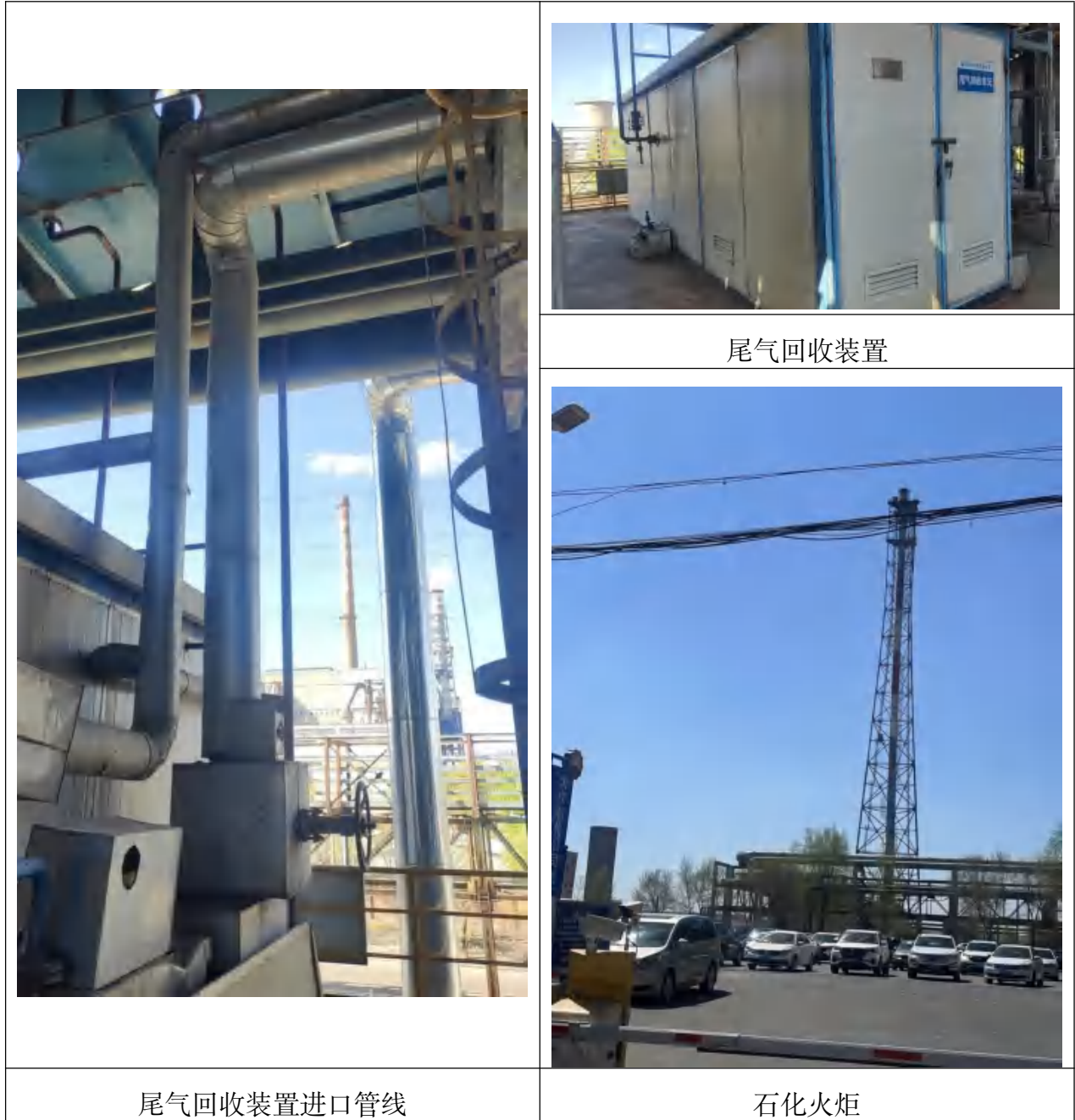
图4-1 废气收集及处理设施图
